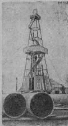
В Подмосквинском угольном бассейне впервые начато скоростное строительство шахт методом бурения стволов. На снимке: общий вид буровой вышки. На переднем плане обсадные трубы. Фото В. Давыдова (Фотохранилище ТАСС).
